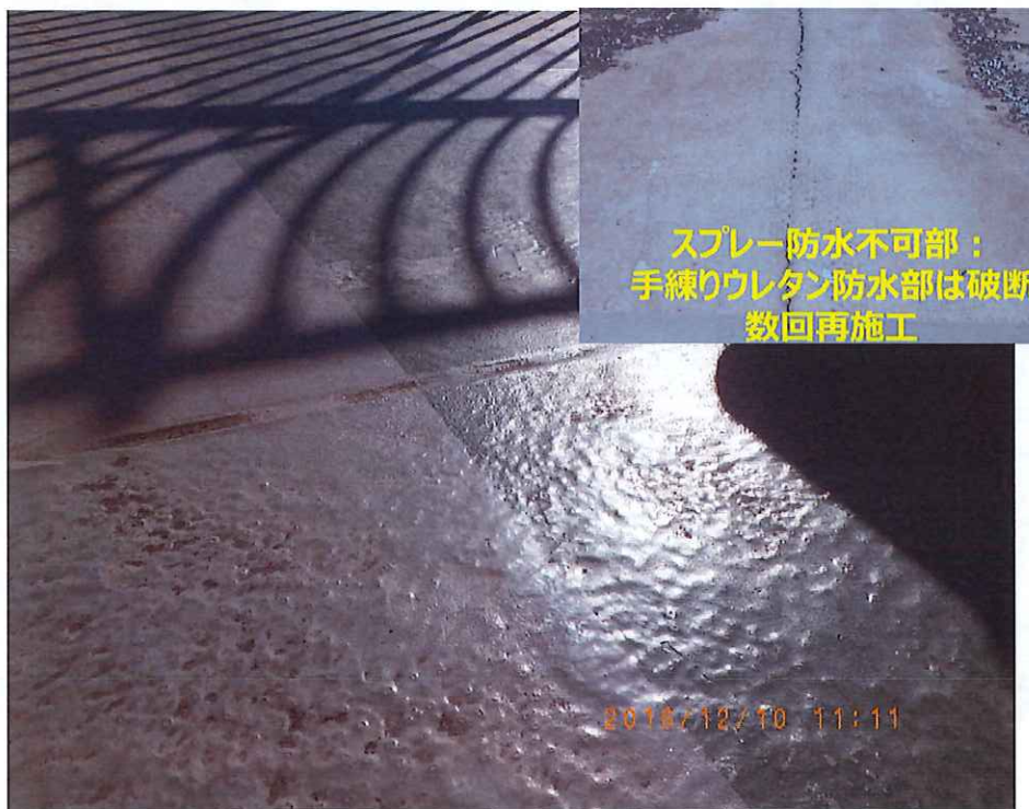
2016年12月Kビル15年点検写真（吸気口があるため水性 トップコートで施工⇒トップコート消失） 超高層ビル屋上：10年前の3・11の揺れにも損傷なし
