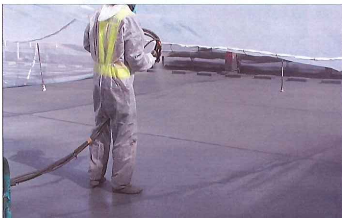
2017年5月30年経年の立体駐車場屋上防水
