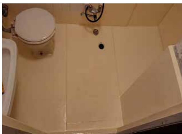
施工完了。 3時間後にはシーリング材がほぼ硬化します。速乾型です。
