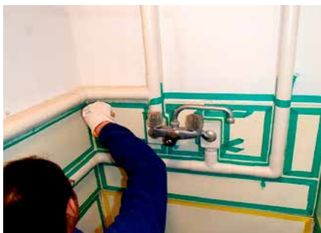
撤去できない配管は配管裏から漏水しないようにシーリング工事をを行います。
